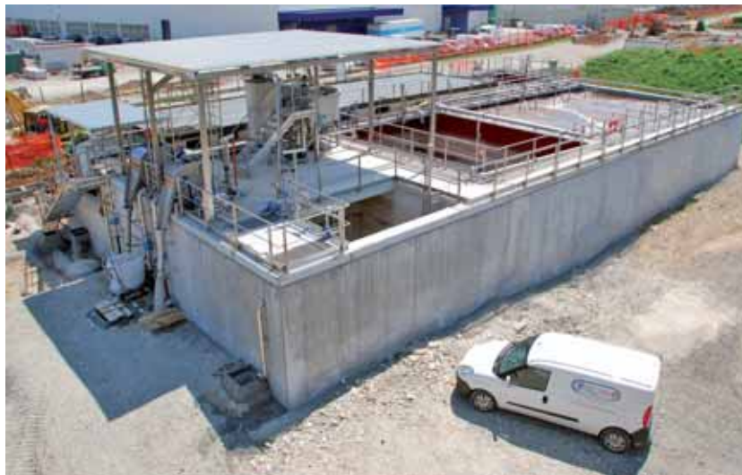
Impianto di trattamento acque completo di sezioni di filtrazione meccanica, stadio chimico/fisico e sezione biologica per l'abbattimento dell'organico disciolto
