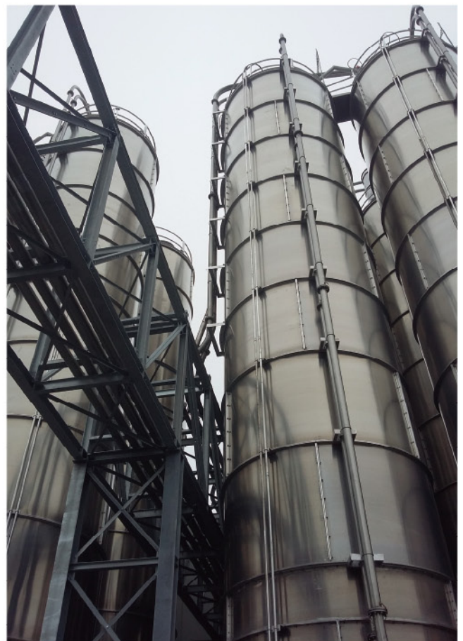
系统的贮料仓部分
