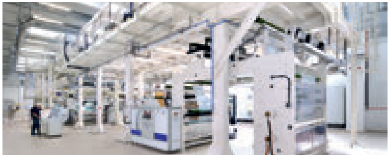
La nuova linea presso lo stabilimento di Coveme, a Gorizia, è installata in un ambiente controllato in sovrappressione con ricircolo d'aria e filtraggio, così da assicurare al processo gli standard di una camera bianca
