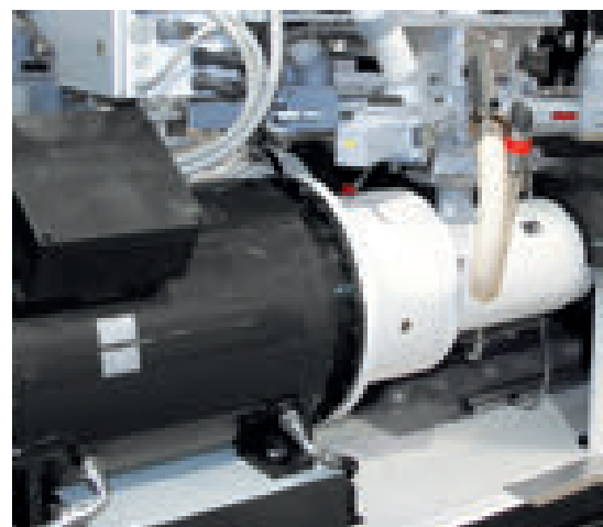
Particolare del motore di un estrusore Macchi con componentistica Siemens
