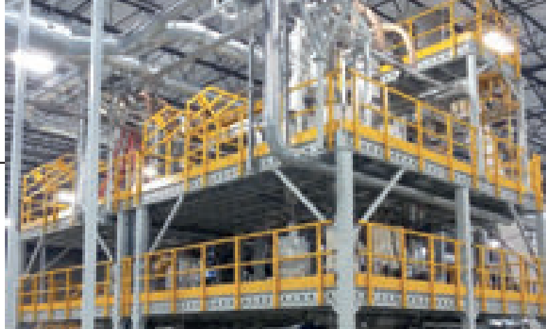
L'impianto è stato concepito per adattarsi all'eventuale futura espansione dello stabilimento del compoundatore, pur garantendo elevati standard di sicurezza
