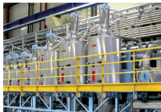
Установка обезвоживания с ОТХ на помосте
